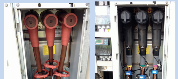
Nachrüstung einer Kompaktstation mit Fehlererfassung und GSM-Fernmeldung
