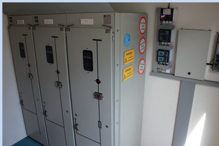
Nachrüstung einer luftisolierten Anlage mit Fehlererfassung und GSM-Fernmeldung
